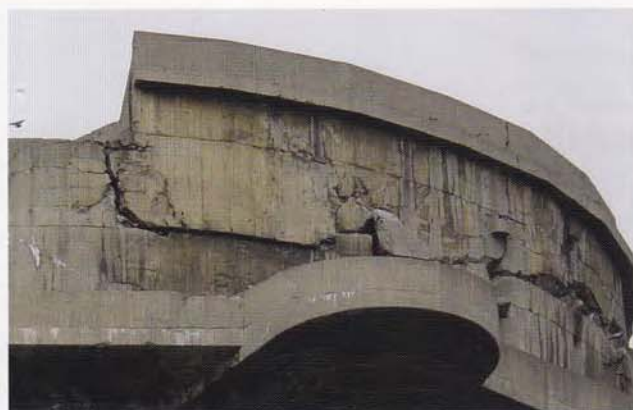
Explosionsschäden am Gefechtsturm Augarten
