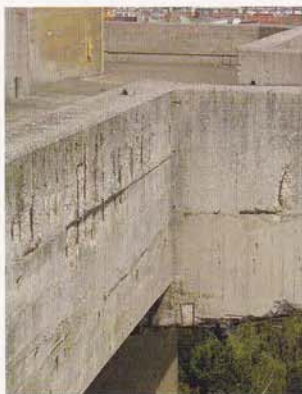
Abplatzen der Betonoberflächen
